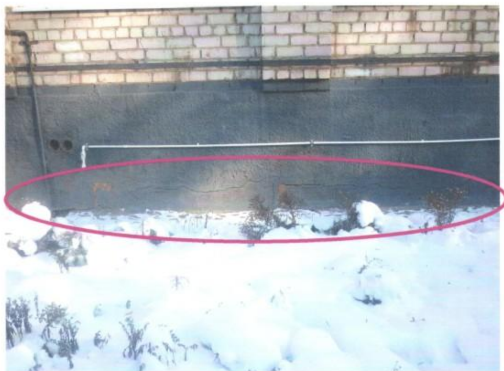
Фото 21-22. Трещины и отслоение штукатурного слоя, следы увлажнения цокольной части стен.
