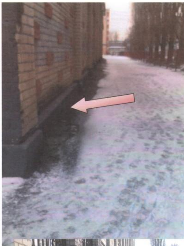
Фото 17,18. Вертикальная планировка территории, прилегающей к зданию лица, не обеспечивает отвод поверхностных вод от фундаментов здания.
