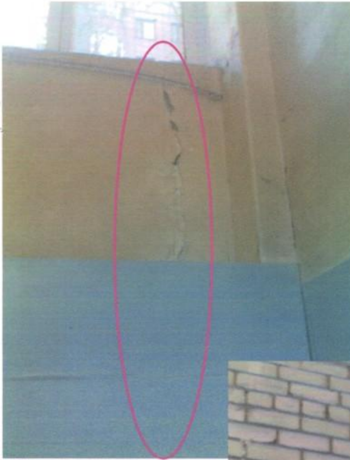
Фото 13,14. Вертикальные трещины в местах сопряжений кирпичных колонн с кирпичной кладкой наружных стен спортзала по осям: «А» и «Б» в пролете «6-10» шириной раскрытия до 3мм.
