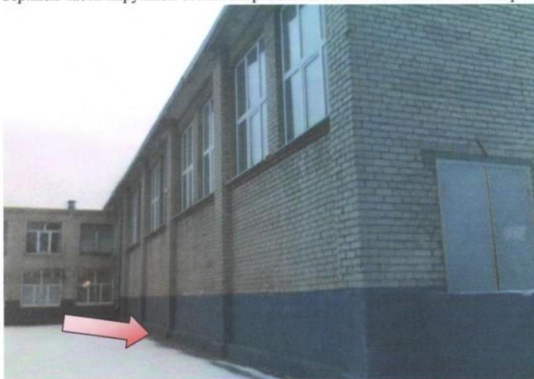
Фото 16. Вертикальная планировка территории, прилегающей к зданию спортзала, не обеспечивает отвод поверхностных вод от фундаментов здания.
